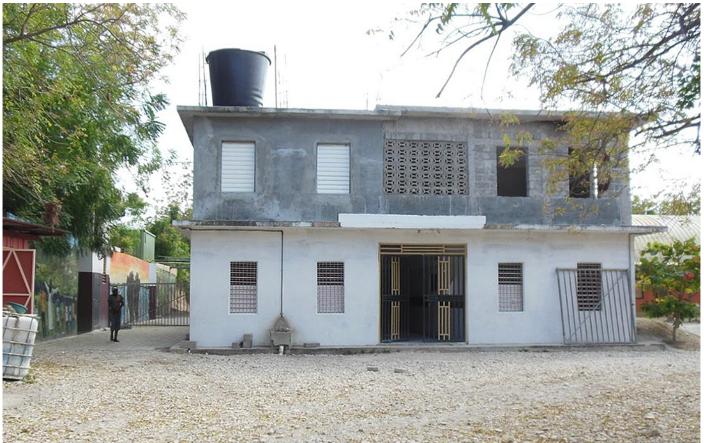
De verdieping staat er op en de ramen zijn inmiddels ook geplaatst. Dit is de achterkant.
